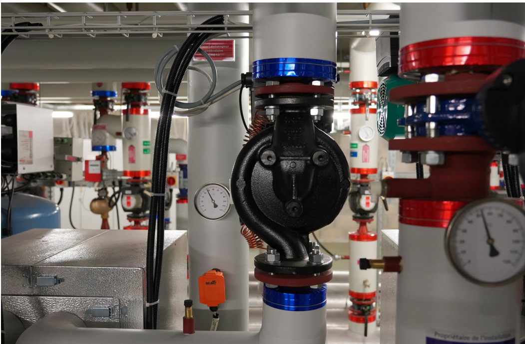
Impianto di free cooling per il manto dello Stade de la Maladière.
