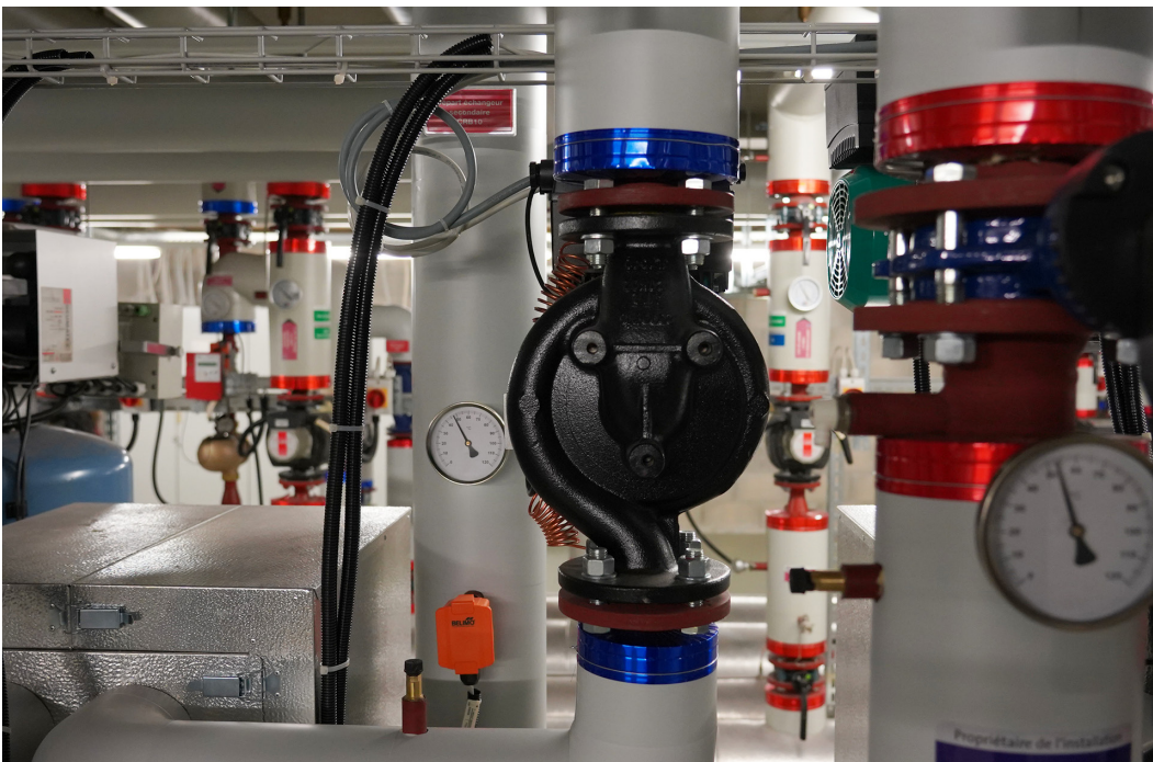
Freecooling-Anlage für den Mantel des Stade de la Maladière.
