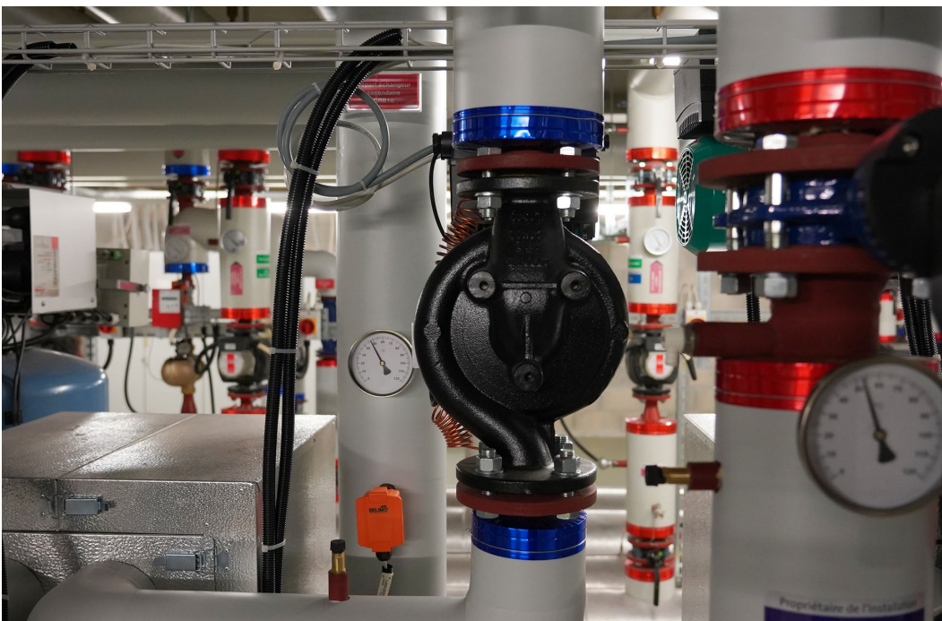
Free cooling system for the shell of the Stade de la Maladière
